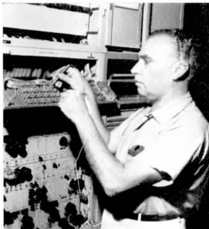
José de Sousa, da Rede Interurbana, medindo corrente de placa no quadro de fusíveis. Trabalho intenso e de alta especialidade na CTB.
