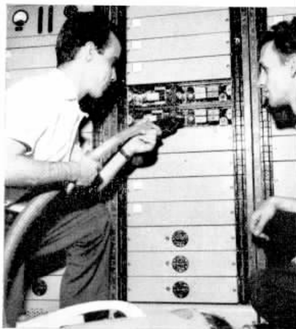
Vicente Libonatti, à direita, encarregado da estação coaxial, observa como vai a limpeza feita por Francisco A. Reis. Circuitos interurbanos em ordem.
