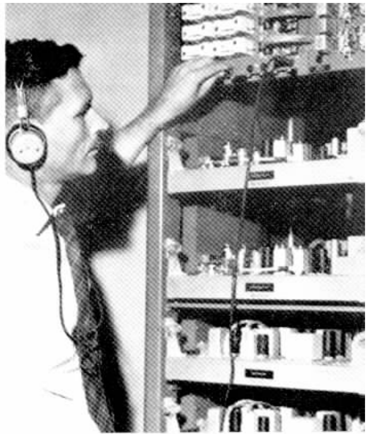
Anelo Sanvido examina o sistema de V.H.F. que permite ligações entre as estações de micro-ondas de São Paulo e Campinas.
