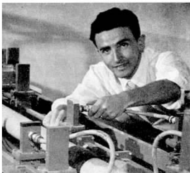
Maurício Pimentel, da Engenharia de Equipamento e Prédios, verifica a conexão do guia de onda ao equipamento da estação.
