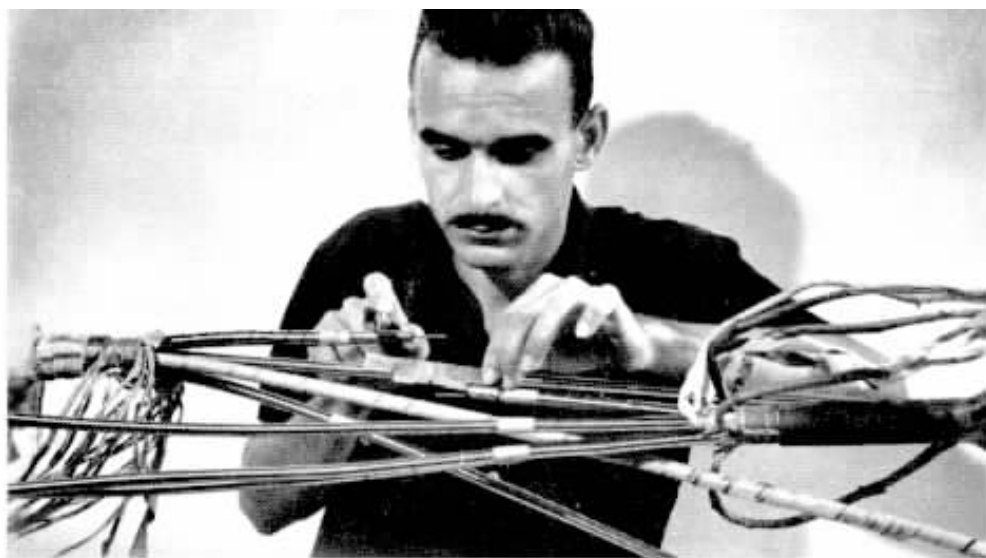
Alberto Passos faz a preparação dos tubos coaxiais para emenda. Para isso é necessário atenção e conhecimento. Na Escola da Rede é aprende a técnica do serviço, para o desempenho da tarefa.
