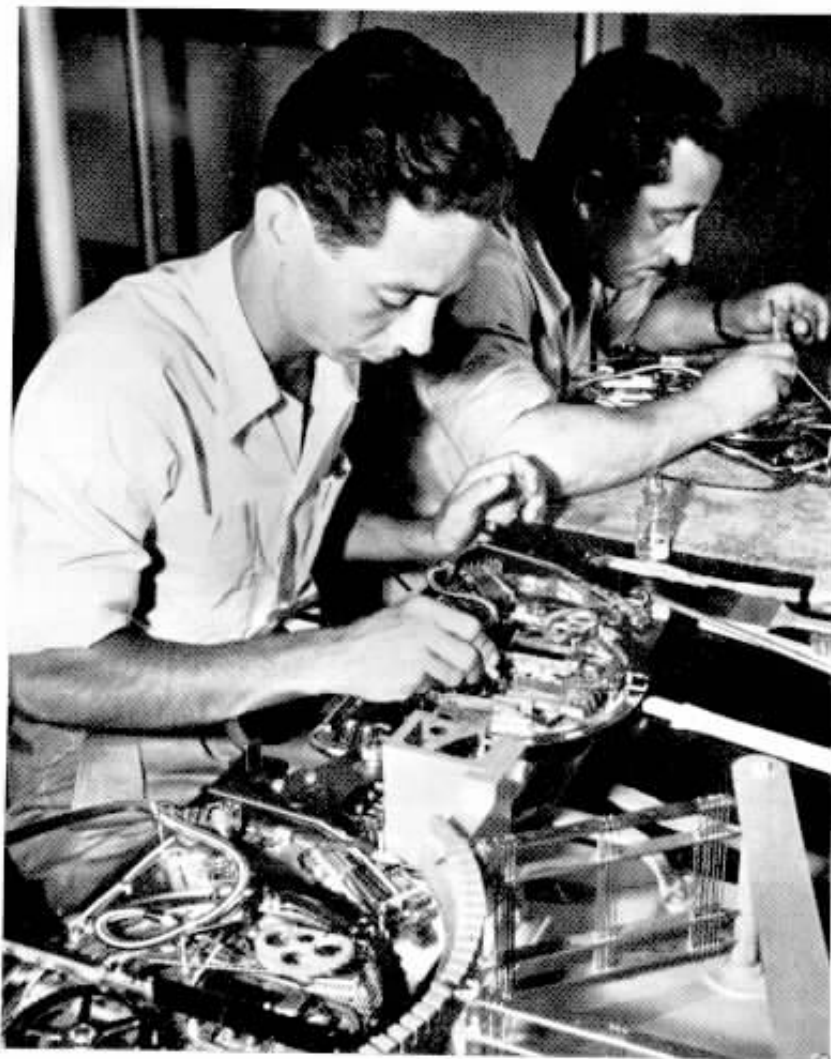
Os conservadores Haroldo da Silva Raposo e Herolino Rodrigues Carvalho inspecionando e ajustando seletores instalados na moderna estação telefônica de Volta Redonda
