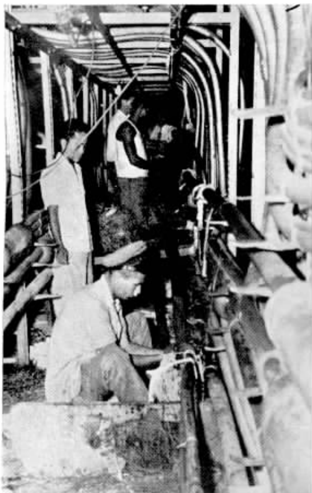
No porão da estação "26-46" o Emendador Jussanan completa o serviço com outros auxiliares
