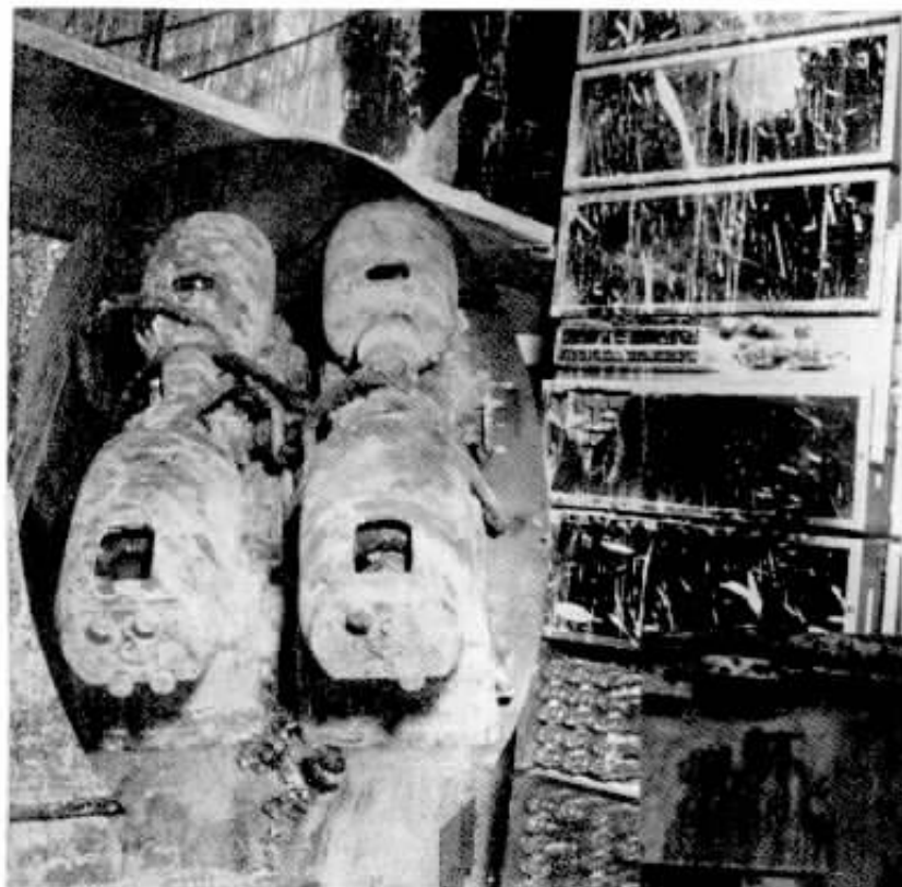
Motores e parte do equipamento incendiado
