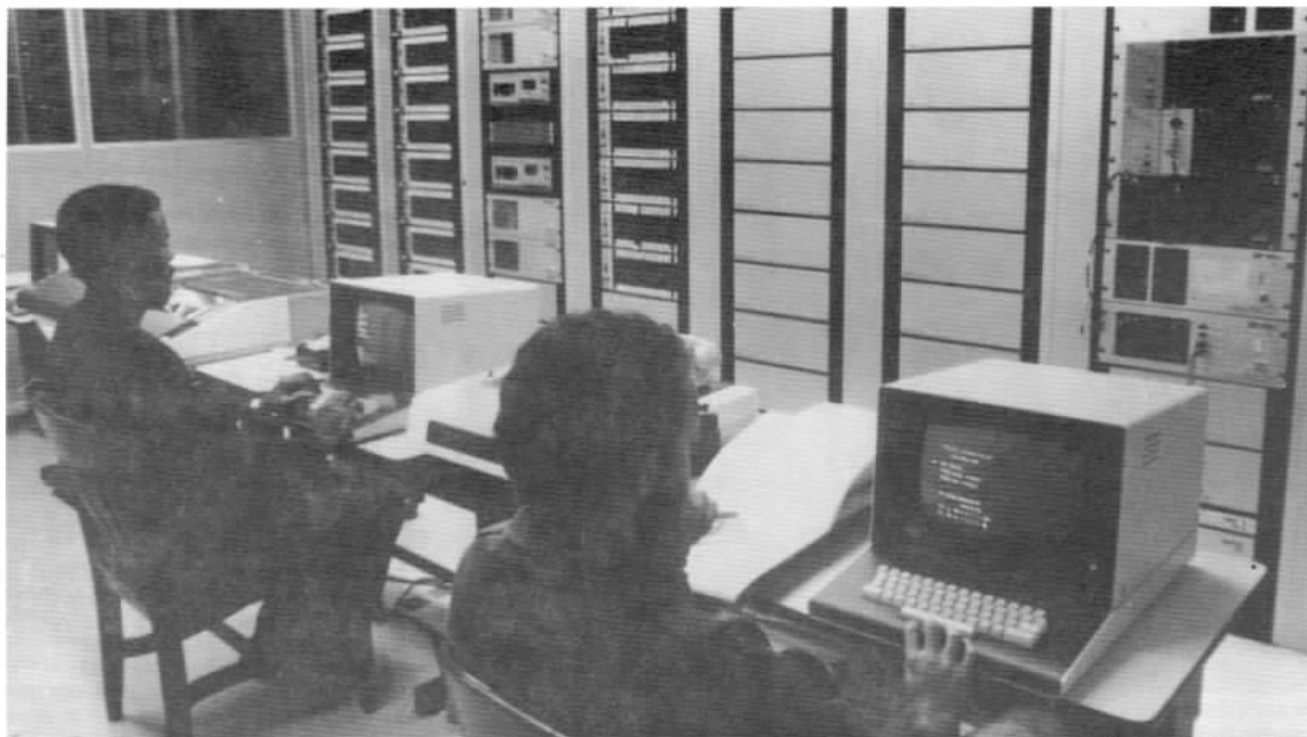
O Sistema de Tarifação e Supervisão – Sitasu – desenvolvido pela Telerj está em operação na estação São Cristóvão.
