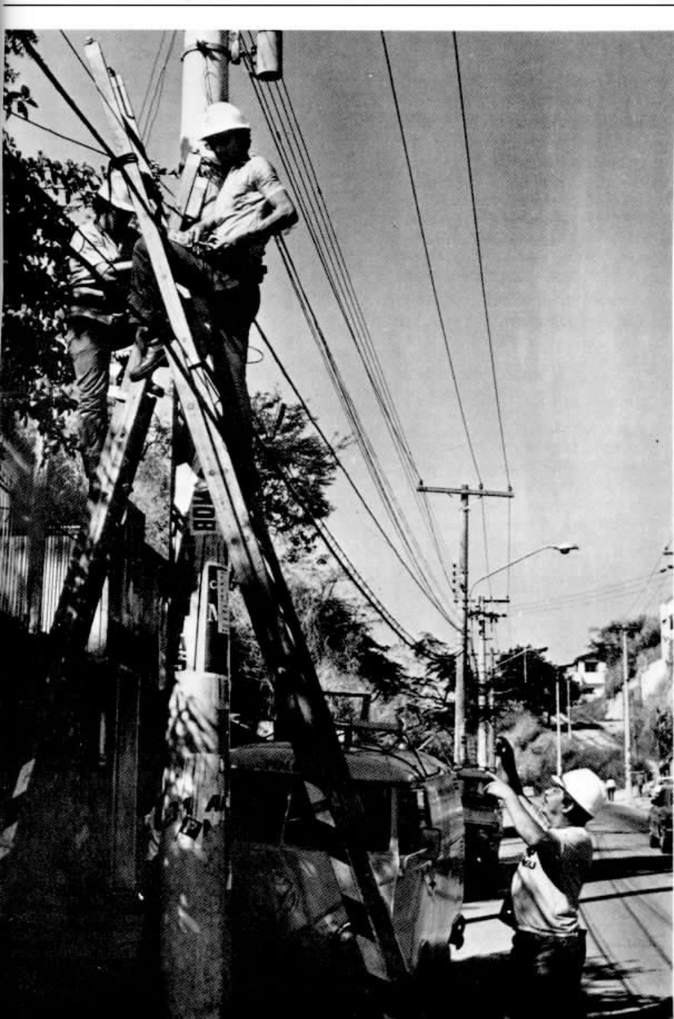
Os serviços das concessionárias, como a Telerj, fazem parte de um sistema integrado de comunicações.
