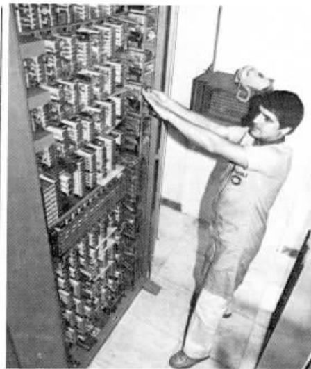
A central de Sumidouro tem capacidade para 64 terminais.
