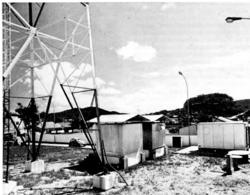
A central telefônica de Iguaba Grande está montada em três cabines-reboques
