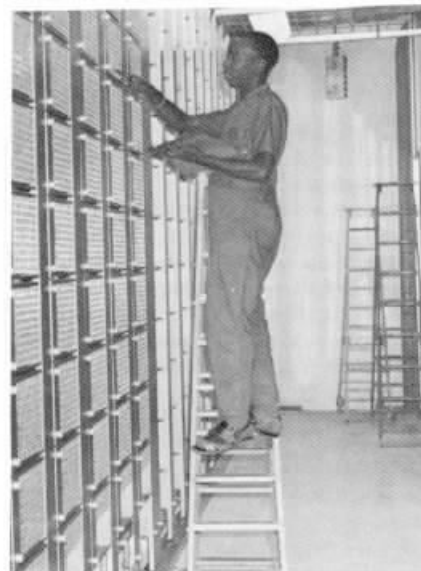
Painel com contadores de impulsos
