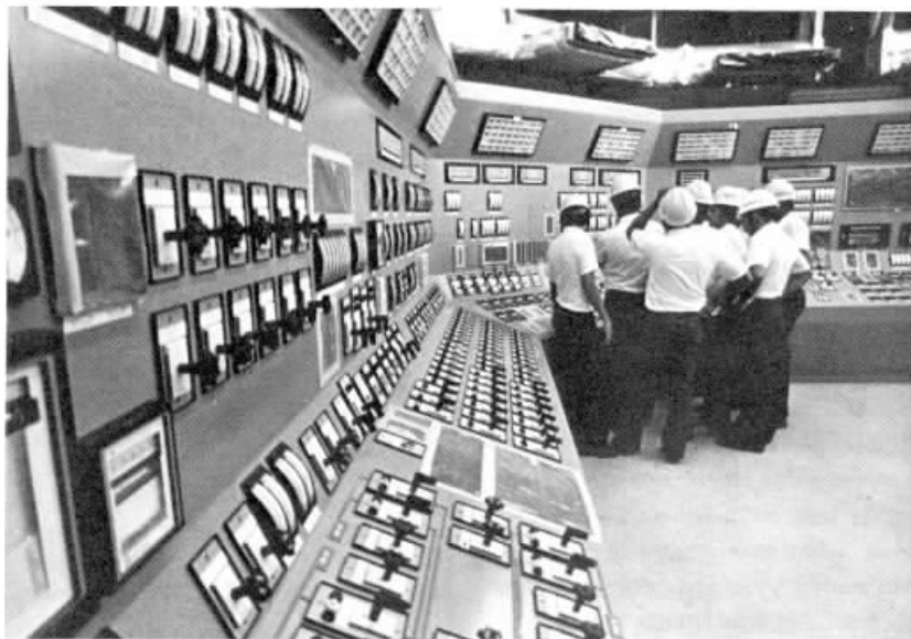
Da sala de controle, o acionamento de toda a usina.
