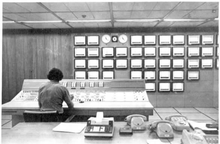
Da sede de Furnas, no Rio, o contato diário com a usina.
