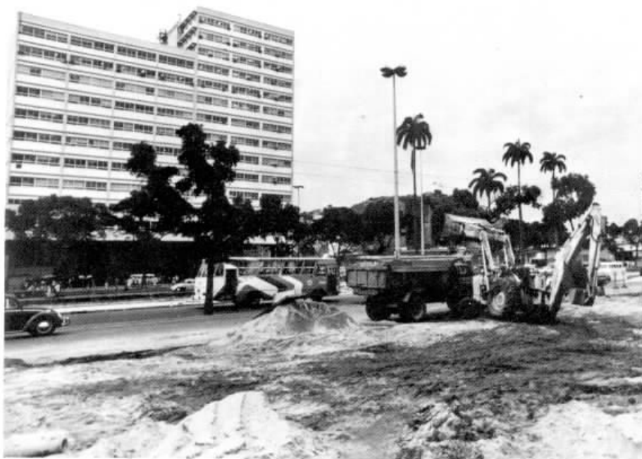
A rota de cabos, na Cidade Nova, atenderá o edifício dos Correios.
