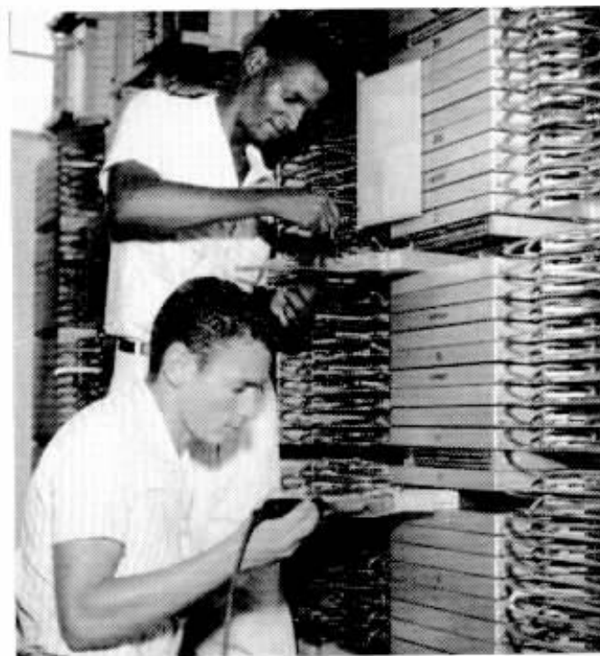
Claudino Francisco dos Santos e Olavo Pereira de Aragão, este abaixado, são conservadores e zelam pelo bom rendimento do equipamento instalado.
