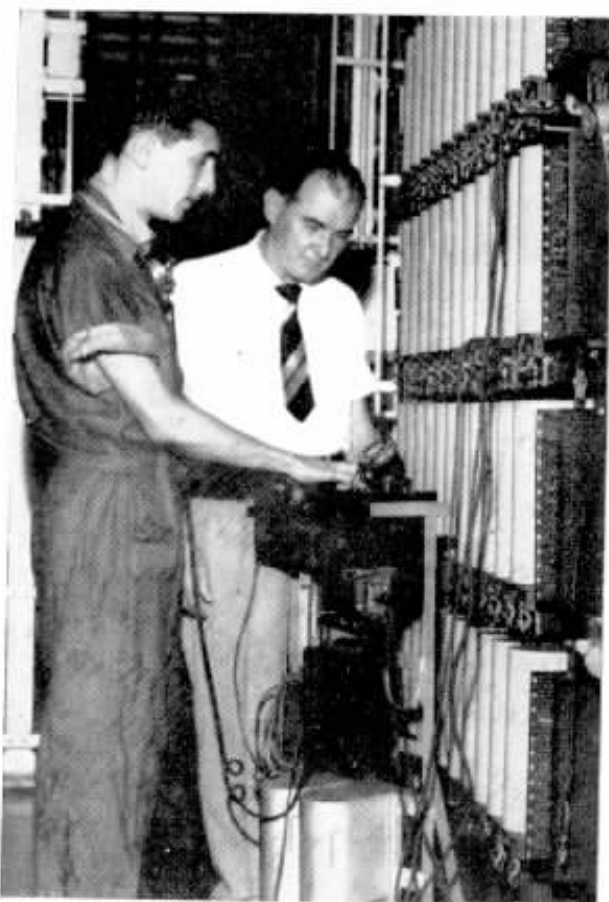
Junto à máquina de teste de comutadores, Osvaldo Franco, encarregado da estação de Petrópolis, examina o trabalho de Renato M. Matos, conservador. Tudo está O. K.
