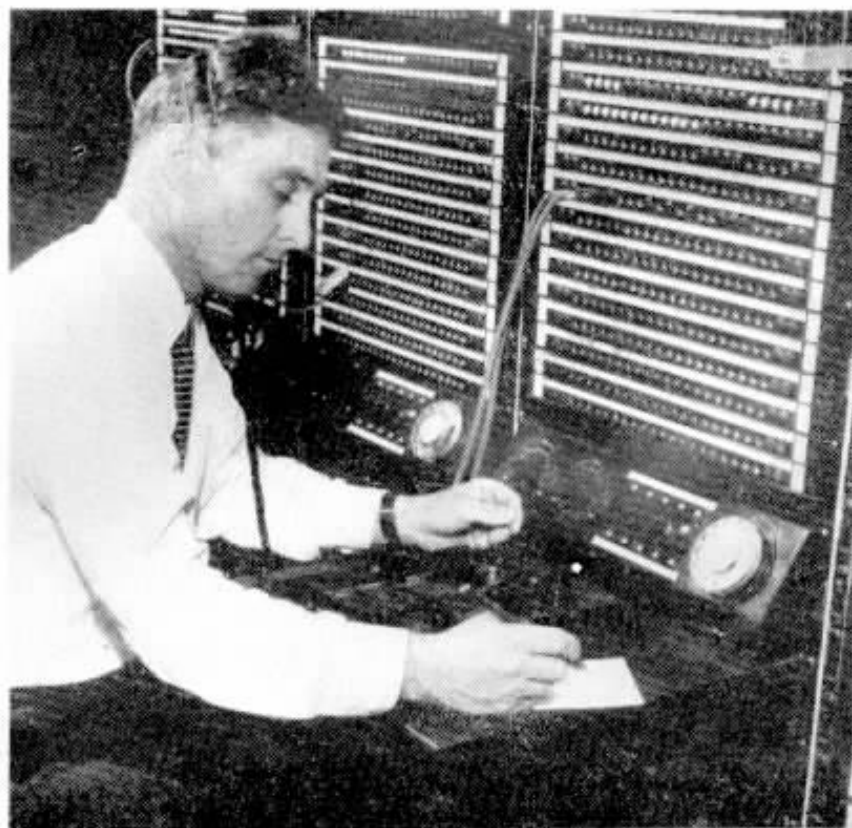
Vladimir Kaiujnikoff , chefe da seção da Rêde Interurbana da Divisão do Estado do Rio, testando os novos circuitos na mesa de provas da estação de Petrópolis. Aumentaram de muito as possibilidades de ligações pelo novo equipamento pôsto ao serviço das cidades citadas.
