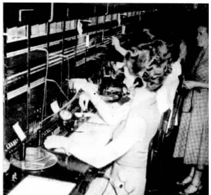
Posições da mesa interurbana em Petrópolis onde entra o cabo coaxial
