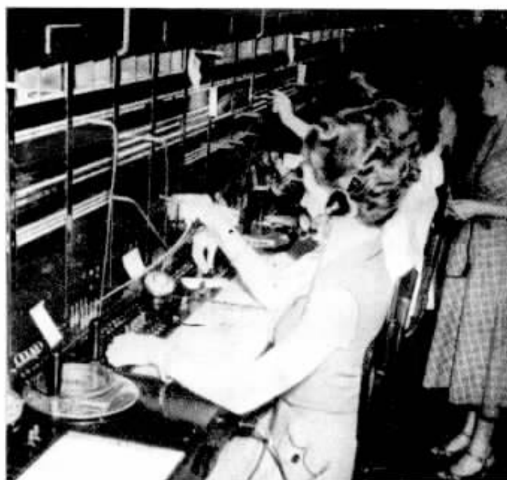
Posições da mesa interurbana em Petrópolis onde entra o cabo coaxial
