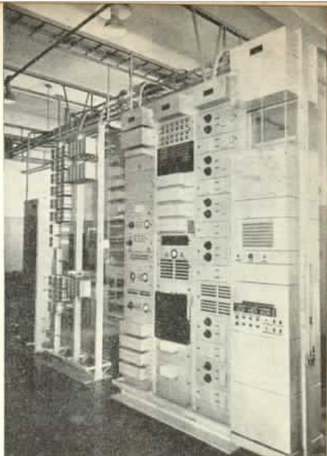
Repetidores da Estação Interurbana.
