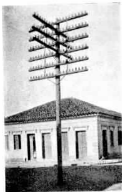
Outro aspecto da antiga rede de fio nu, substituído pela moderna rede de cabos aéreos.
