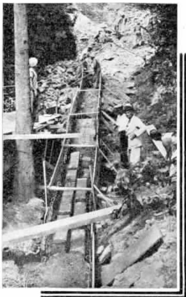
Vista da construção no interior do "Jardim Laranjeiras", mostrando a travessia dos dutos sobre pilastras de concreto armado e a vala aberta na rocha.
