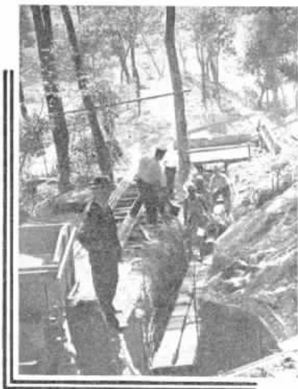
Trecho de construção no bairro "Jardim Laranjeiras", mostrando uma caixa subterrânea e parte do terceiro lance de dutos. A esquerda, no primeiro plano, Bruno E. Nickes, da Secção de Estudos da Planta, do Distrito Federal, que dirigiu todos os trabalhos de campo.
