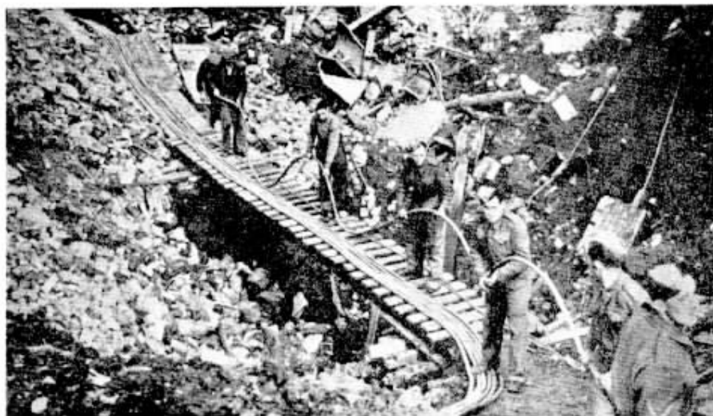
Vê-se nessa gravura uma ponte provisória feita apressadamente por homens da Engenharia Real de Londres sobre uma cratera de bomba e sobre a ponte os cabos não arreventados refiados dentre os destroços, para que não sofra interrupção o serviço telefônico, mais necessário ainda nessa emergência.
